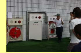
消火体験(屋内消火栓)
